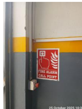
Fire Alarm Point.jpg
